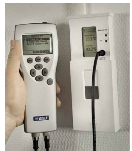
Vor-Ort-Kalibrierung eines Feuchtemesswertgebers HMW90 mit einem portablen Messgerät HM70.
