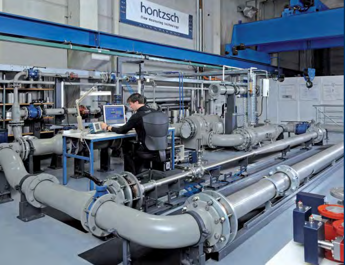
Volumenstrom-Kalibrieranlage , Messbereich 0,20 ... 4000 m 3 /h, Drücke bis 10 bar, 1 MPa, Nennweite bis DN 200
